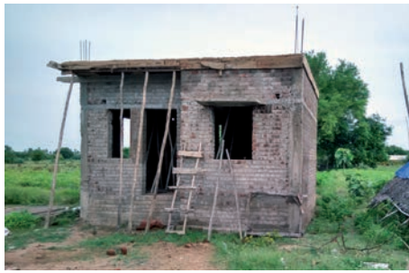
Klein, aber solide sind die neuen Häuser mit 28 m 2 Wohnfläche. Für die Narikuravars werden sie im Vergleich zu den einfachen Hütten eine enorme Verbesserung sein.
